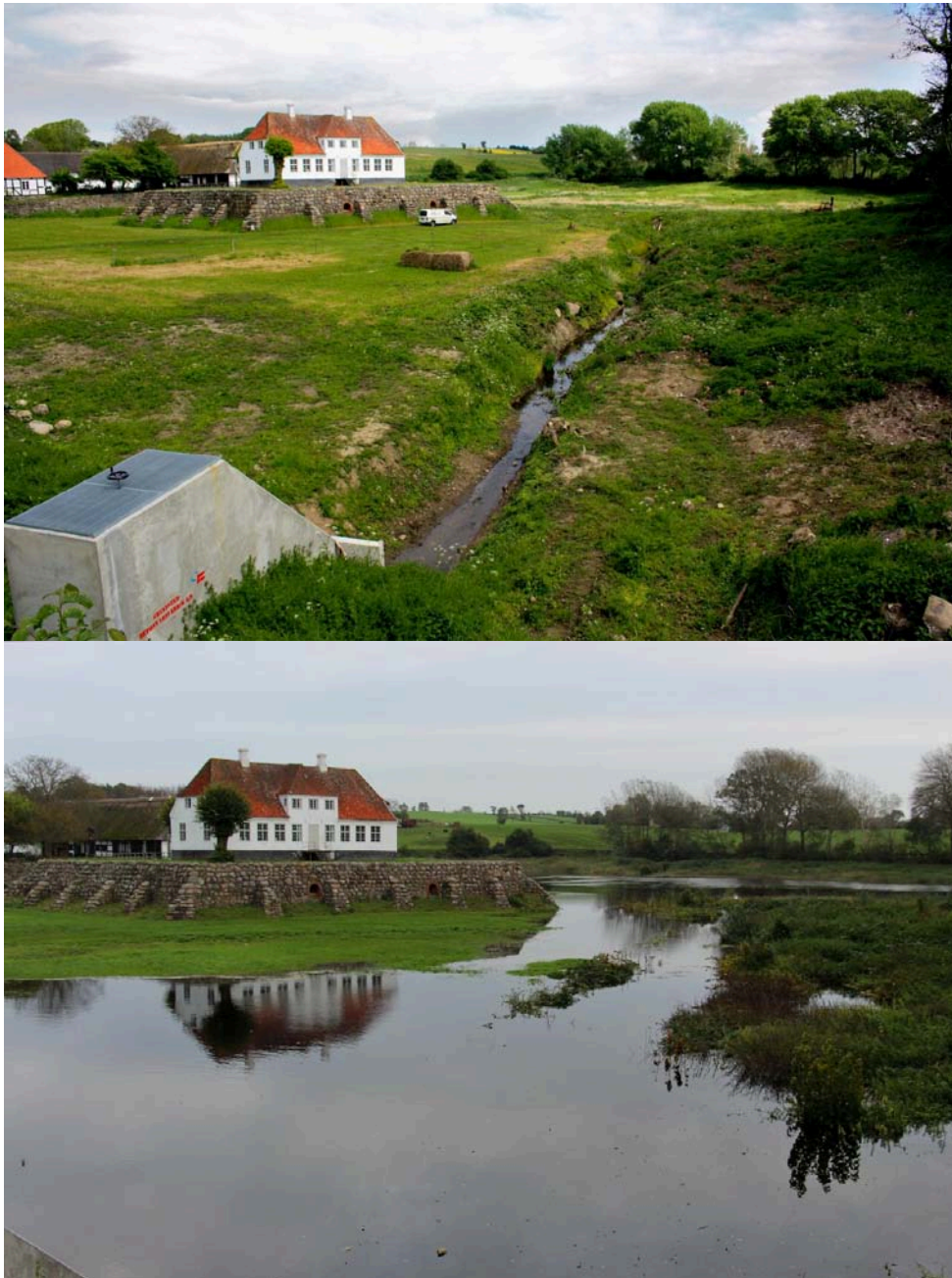
Figur 4 Øverste billede fra etableringen af stemmeværket. Nederste samme sted cirka 3 måneder senere.
